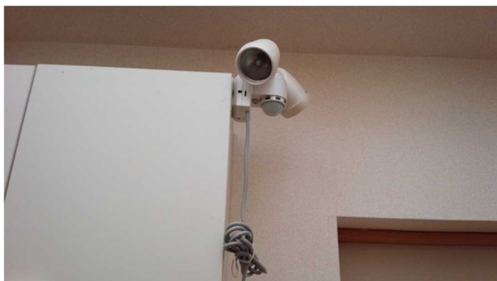
居室前に設置したセンサーライト
